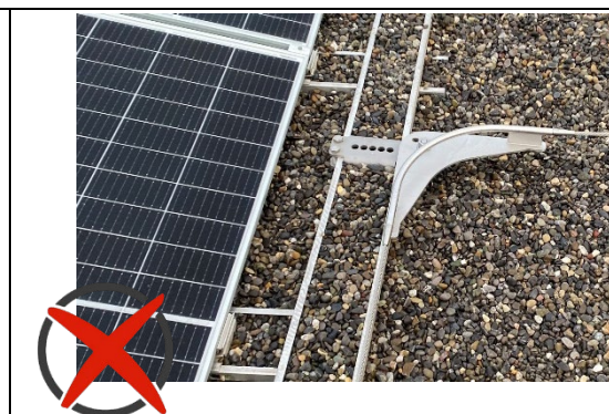
Bild 11: Falsche Installation eines Eckelementes, da auf unbelasteter Grundschiene (parallel zum First) befestigt
